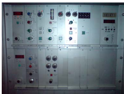
Slika 2. Upravljački ormarić VF pulzatora
